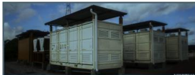
Batterie Sodium-Nickel. Zebra. Fiamm
