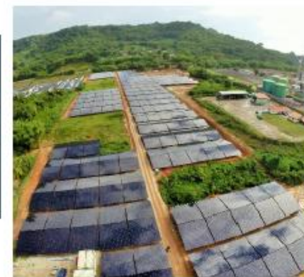
Ferme PV (5MWc) et batterie (2MW- 4 MWh). Montjoly (Guvane). MSSE
