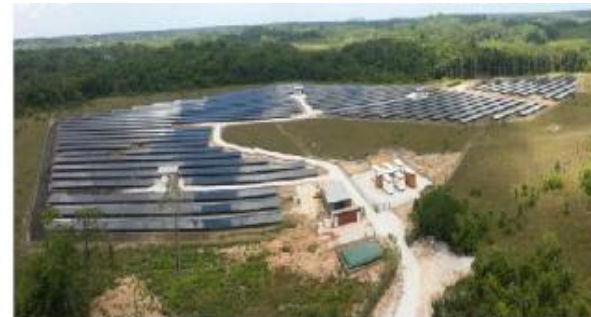
Ferme PV (5MWc) et batterie (2MW-4,5 MWh). Toucan (Guyane). EDF EN
