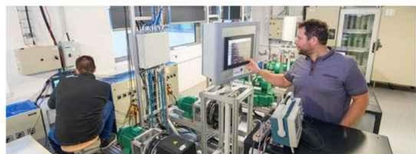
La salle des machines du micro-réseau électrique intelligent (smart micro grid), au sein du G2Elab, à Grenoble.
