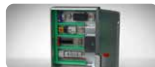
Électricité BT/HTA Automatisme
